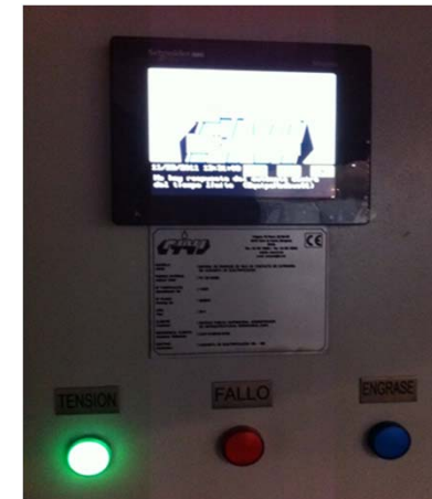
Detalle del armario eléctrico de control
